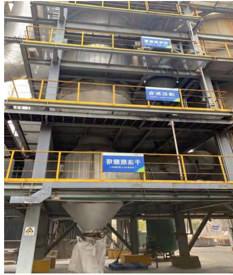
废气治理设施标识牌
