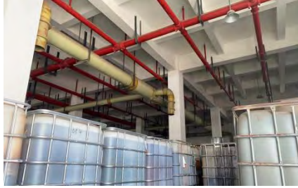
危废暂存库负压收集装置
